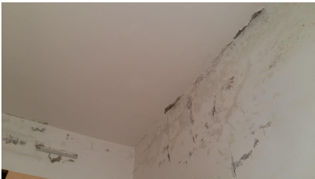
Traces d'infiltration d'eau au niveau de la cage d'escalier de l'immeuble BAAL
