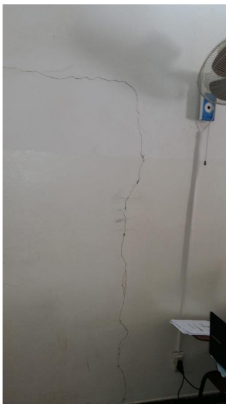
Site ESCALE : fissures sur murs
