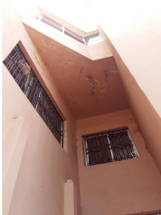
Immeuble BAAL : défauts d'étanchéité
