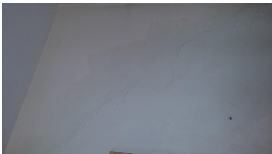
Immeuble BAAL : quelques fissures sur murs
