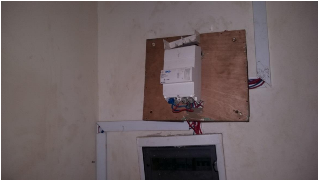
Immeuble BAAL : installation électrique à protéger
