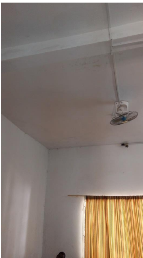
Site ESCALE : étanchéité à améliorer ; poutre fléchie
